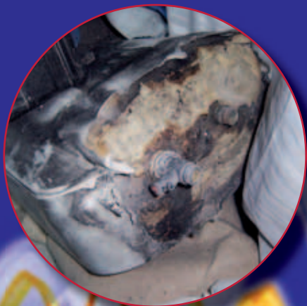
Ein abgebrannter Boiler im Hause von Nino Pezzino.
